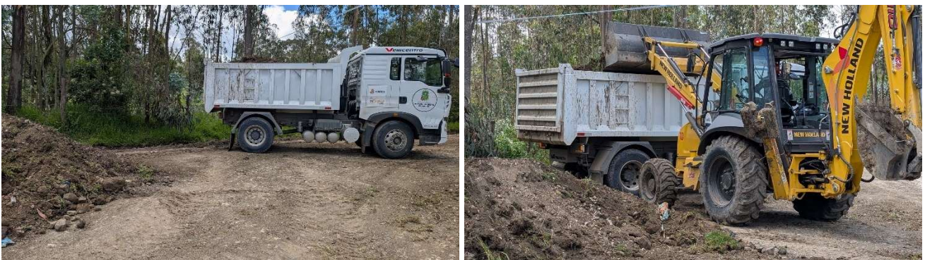
Foto 17: Programa de mantenimiento vial Azhapud
